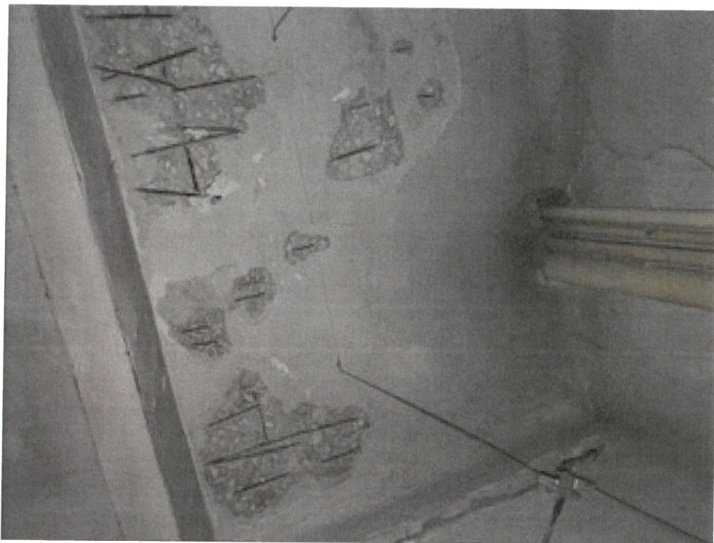
Sl. br. 2 urušavanje zaštitnog sloja betona, komplet sa žbukom ( upitna armatura u a.b. ploči)
