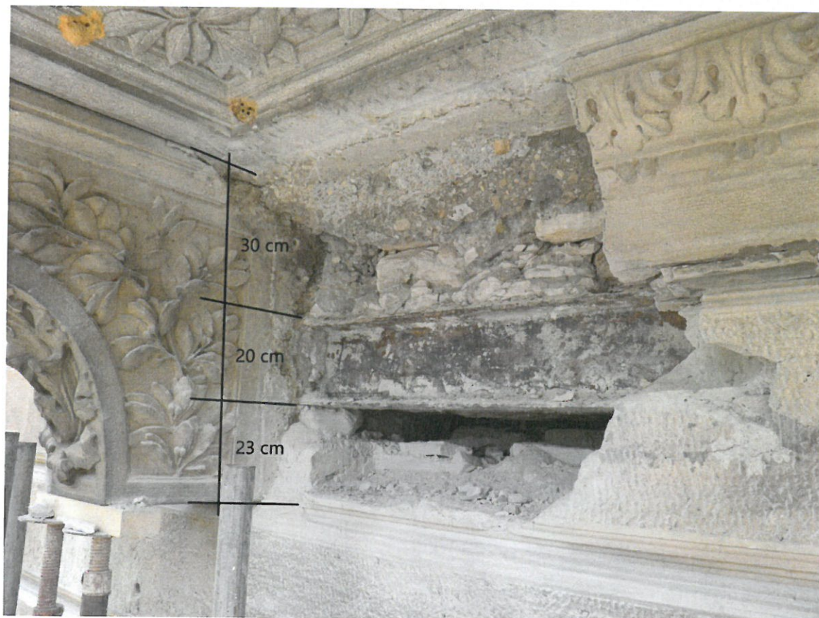
Sl. br. 1. Oštećenje nosive konzole balkona ( kosa pukotina na ivici I profila- prekoračenje gl. vl. napona) – progib moguće urušavanje
